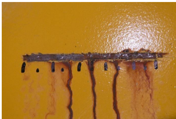
Obrázek 14: P1.9 – koroze v řezu
